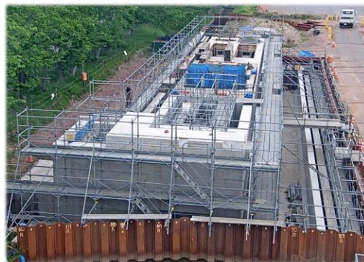
福島潟2号排水機場本体工
